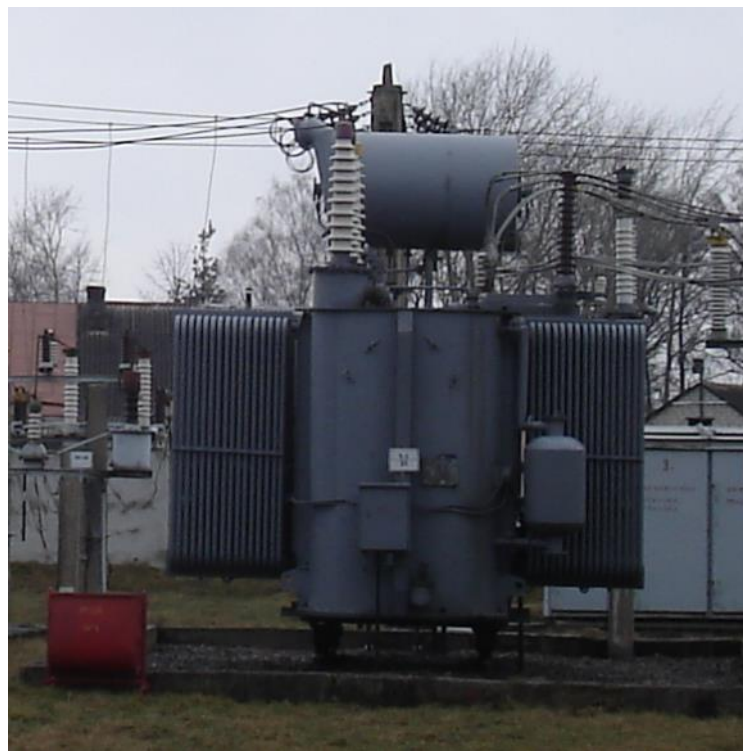
Рисунок 1 – Трансформатор ТРДН-25000/110 на ПС-110 «Занеманская».
